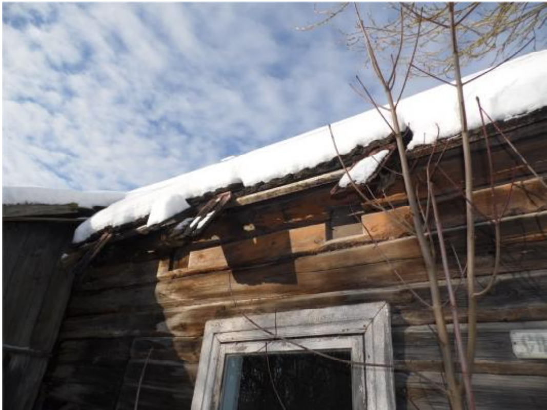
Фото №7. Единичные участки обрушение конструкции кровли.
