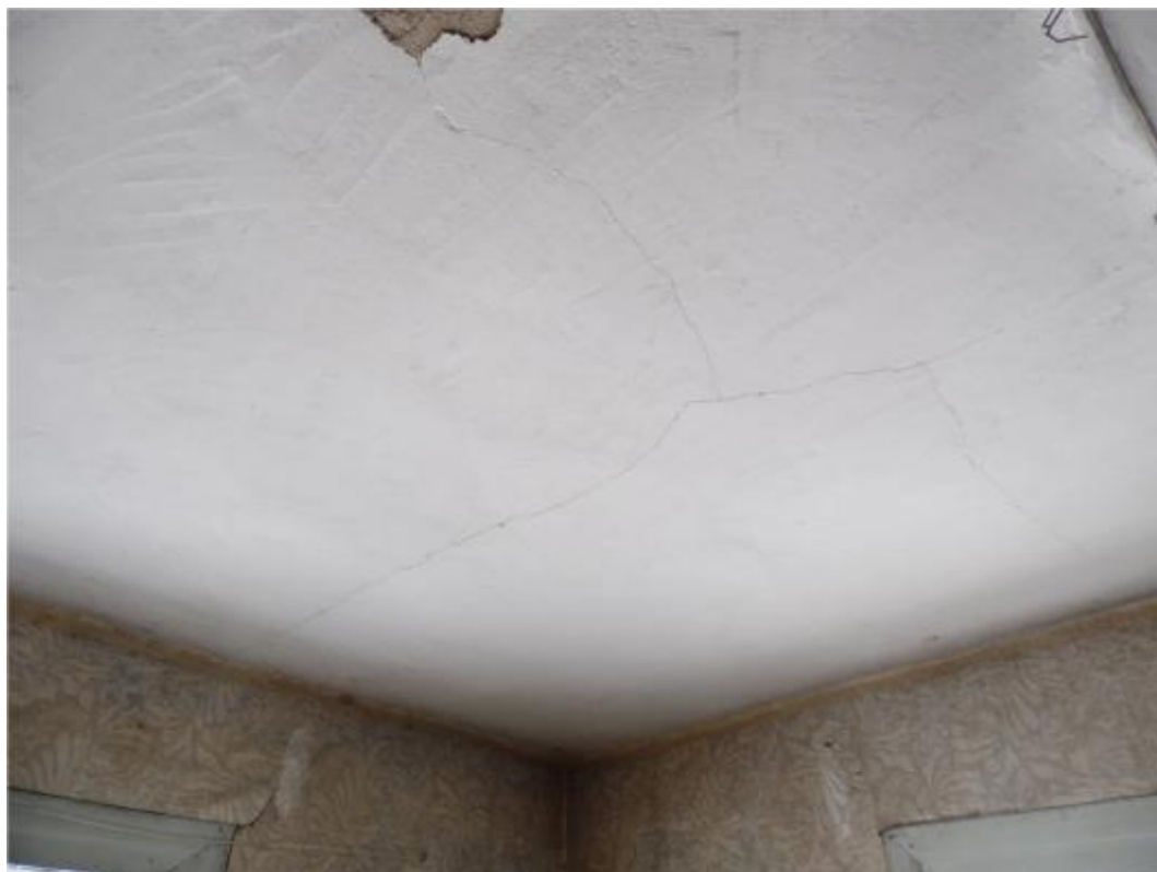
Фото №13. Провисание конструкции потолка, вызванное деформацией чердачного перекрытия. Многочисленные трещины в отделочном штукатурном слое потолка.
