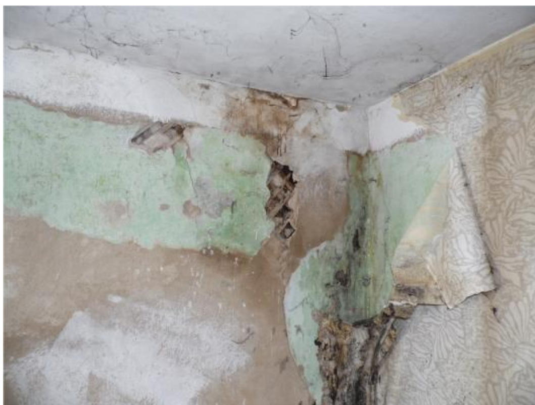
Фото №14. Массовые трещины во внутреннем отделочном штукатурном слое стен здания. Отслоение штукатурного слоя.
