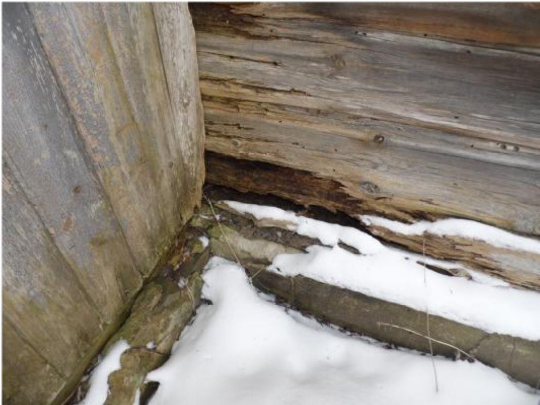
Фото №5. Участки поражения деструктивной гнилью бревен наружных стен здания с уменьшением поперечного сечения на 80%.
