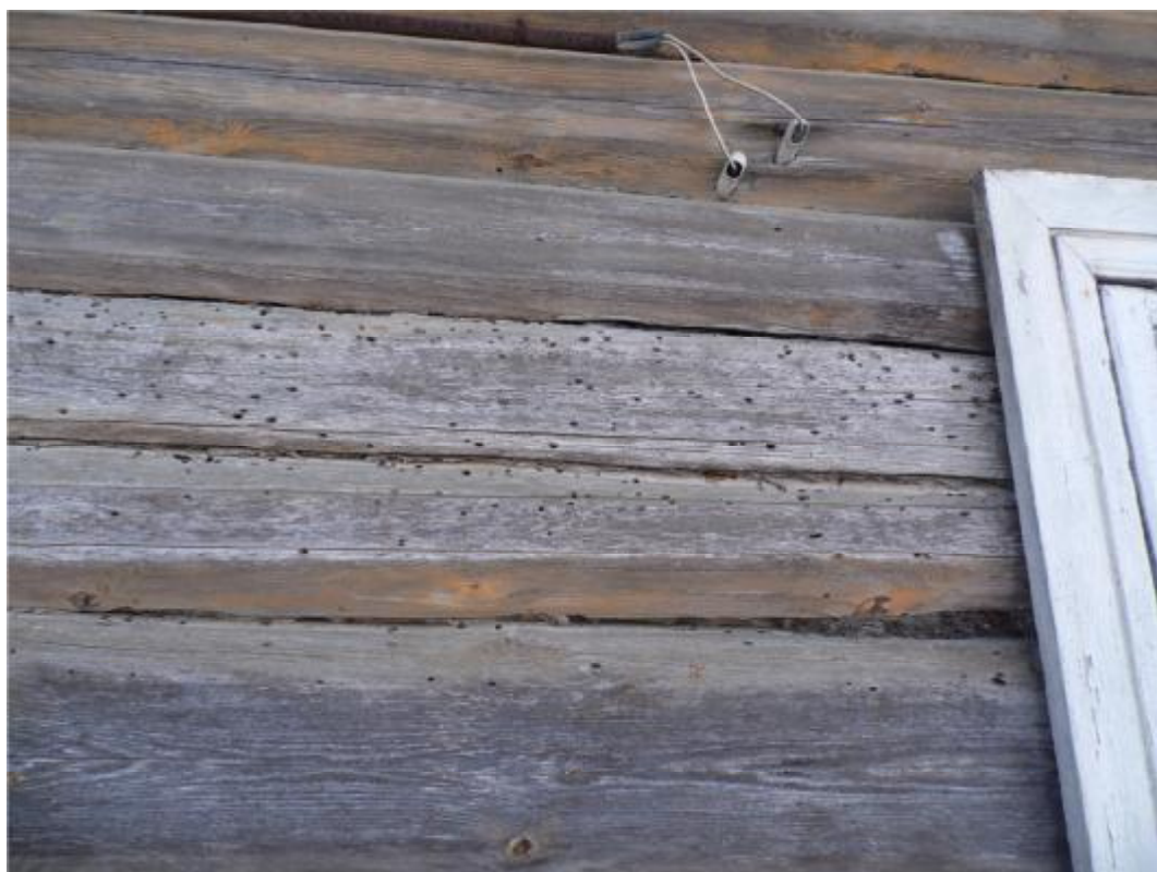
Фото №4. Следы поражения брусьев наружных стен жуком-древоточцем.
