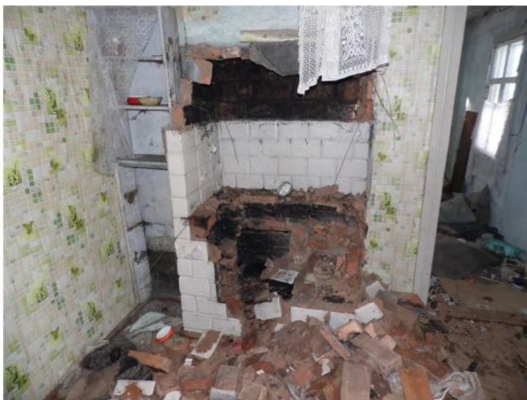
Фото №9, №10. Участки разрушения кирпичной кладки печей.
