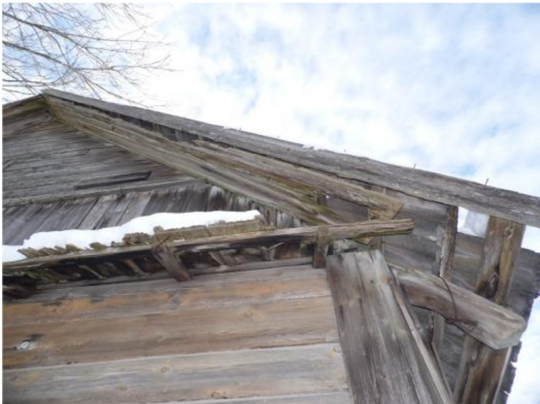
Фото №8. Поражение деструктивной гнилью конструкций подшивки карниза.
