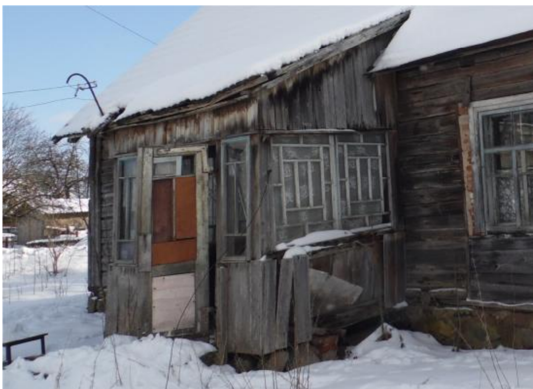
Фото №12. Участки поражения деструктивной гнилью досок обшивки стен пристроек, а также частичное отсутствие кровли. Многочисленные участки выпадения камней из «тела» бутовой кладки цоколя и фундамента.
