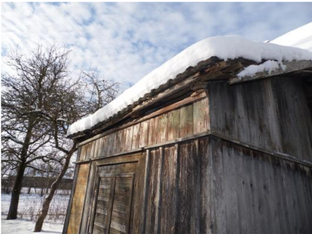
Фото №6. «Провисание» кровли.
