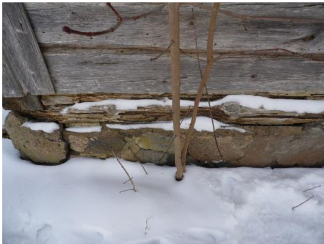
Фото №3. Участки размораживания и выветривания растворной составляющей бутовой кладки цоколя. Участки поражения деструктивной гнилью брусьев наружных стен здания с уменьшением поперечного сечения на 80%.
